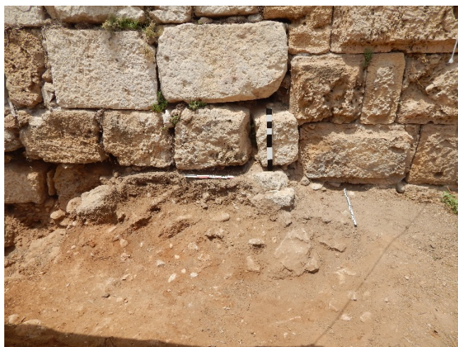
Figure 6 : Pierres disposées en quinconce pour stabiliser un affaissement dans la courtine (Photo : Anis Chaaya).
